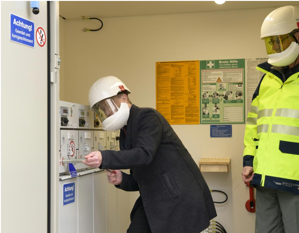
Foto Fotoatelier Schrön: Bad Salzungenens Bürgermeister Klaus Bohl legte zusammen mit WerraEnergie Geschäftsführer Hans Ulrich Nager den Hebel für die moderne Stromversorgung im Bad Salzunger Wohngebiet „An den Beeten“ um.
