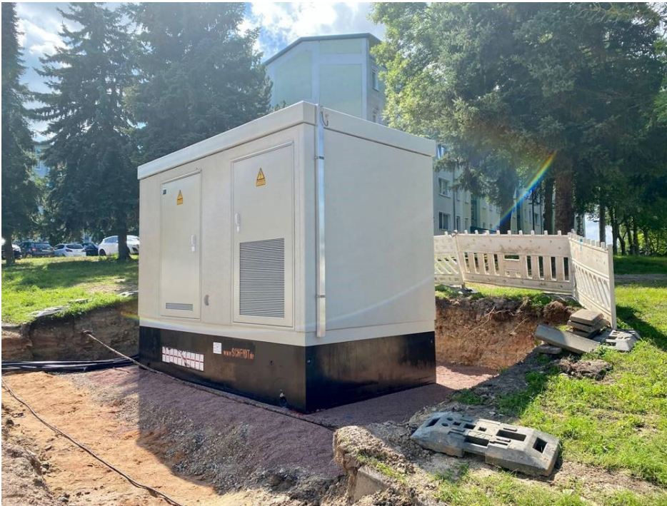
Bild: fertig installierte Trafostation Quelle: Stadtverwaltung Bad Salzungen
